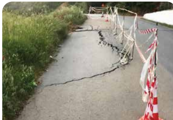
επικίνδυνο επαρχιακό οδικό δίκτυο
